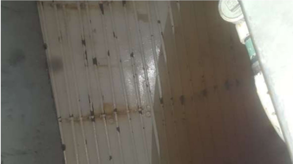
Los serpentines de las cubas sin mantenimiento, presentan corrosión.
