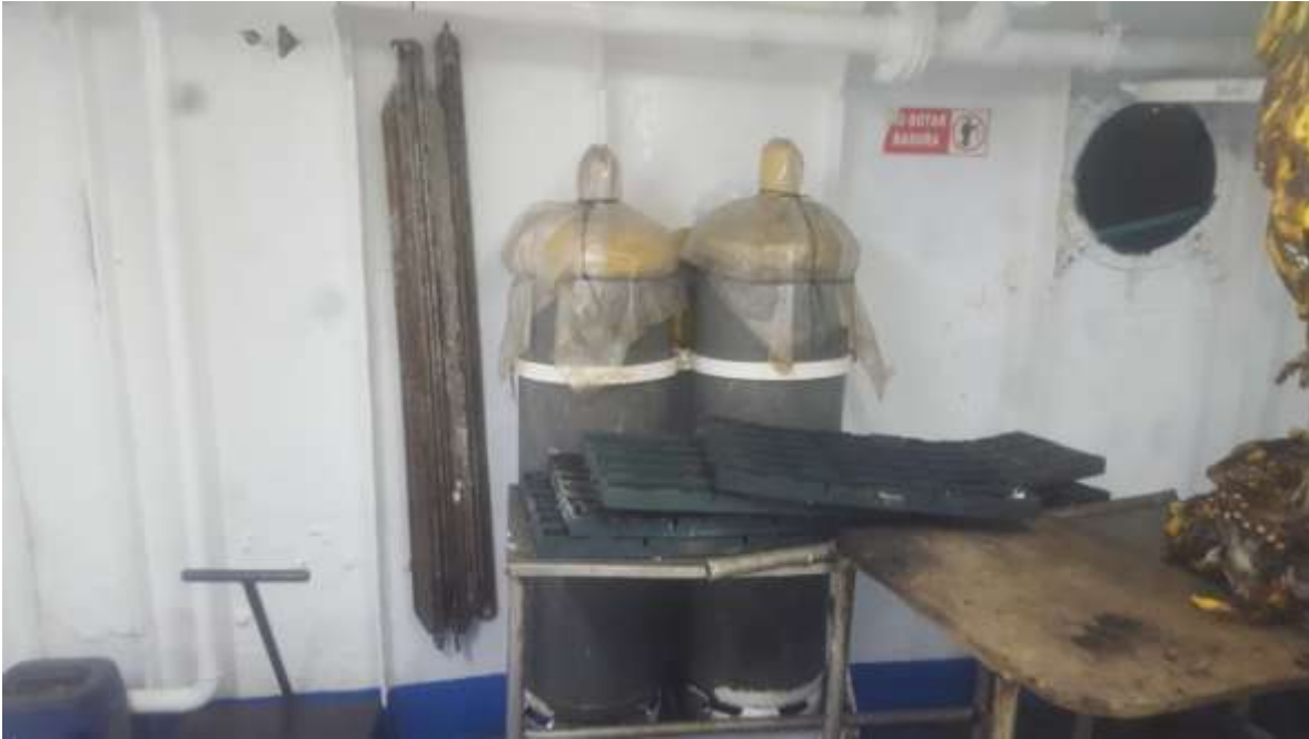
No hay protección adecuada para los cilindros de amoniaco.
