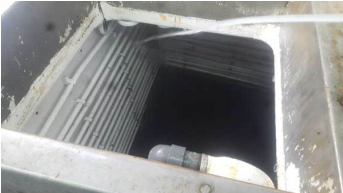
Serpentes defectuosos ocasionados por los golpes al momento de la descarga.
