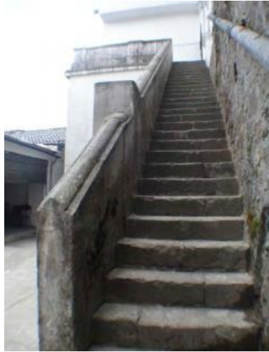
Gráfico No. 13. Escalera acceso secundario de la calle Guayaquil, de la vivienda de García Moreno, San Francisco de Quito, República del Ecuador.
