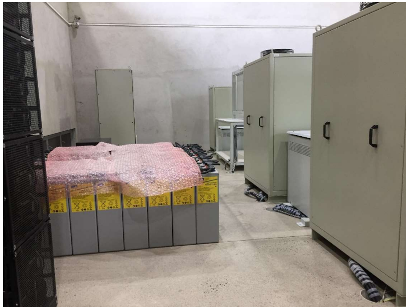
Gráfico No. 20. Conjunto de transformadores, baterías y sistema de procesamiento y transformación de energía ubicadas en planta baja del Centro de Energía Balzay Universidad de Cuenca. Cantón Cuenca. Provincia Azuay. Fuente: Fotografía realizada por los autores de este análisis de caso. [10, mayo, 2018].
