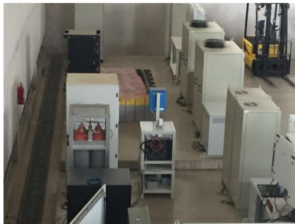
Gráfico No. 16. Sistema de procesamiento y transformación de energía ubicadas en planta baja del Centro de Energía Balzay Universidad de Cuenca. Cantón Cuenca. Provincia Azuay. Fuente: Fotografía realizada por los autores de este análisis de caso. [10, mayo, 2018].
