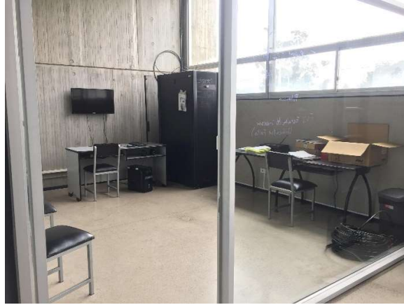
Gráfico No. 14. Oficinas ubicadas en el primer piso del Centro de Energía Balzay Universidad de Cuenca. Cantón Cuenca. Provincia Azuay. Fuente: Fotografía realizada por los autores de este análisis de caso. [10, mayo, 2018].
