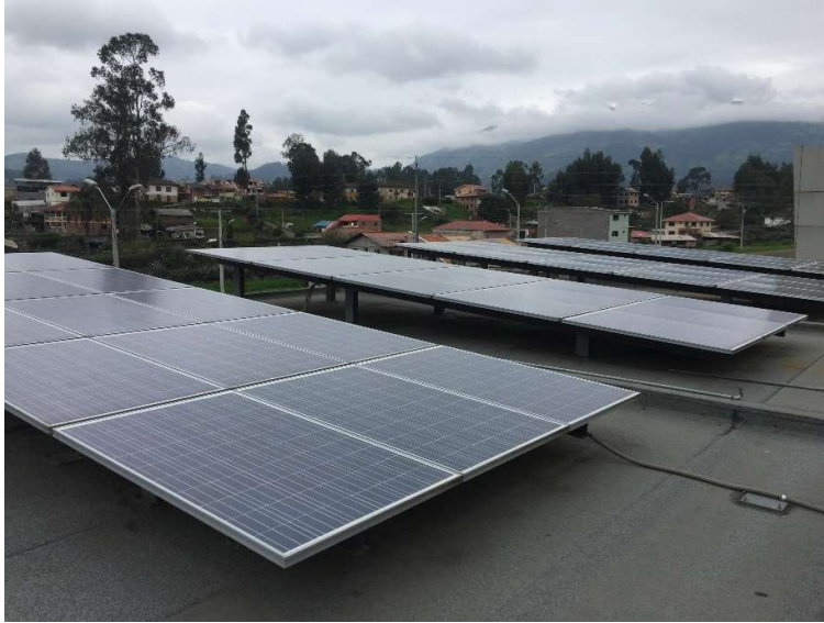
Gráfico No. 17. Paneles fotovoltaicos rígidos instalados en serie y paralelos a un ángulo de 5°, ubicados en la terraza del Centro de Energía Balzay Universidad de Cuenca. Cantón Cuenca. Provincia Azuay. Fuente: Fotografía realizada por los autores de este análisis de caso. [10, mayo, 2018].
