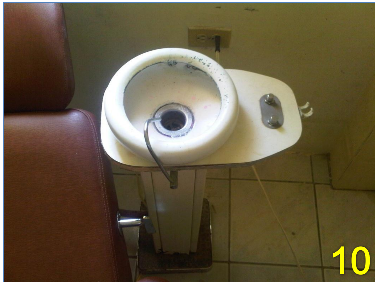
Foto N° 10. Escupidera en estado obsoleto
