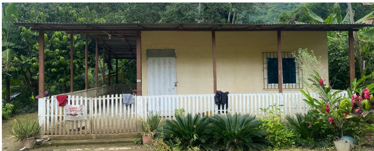
Figura 99. Estado actual de la fachada frontal vivienda N° 5.
