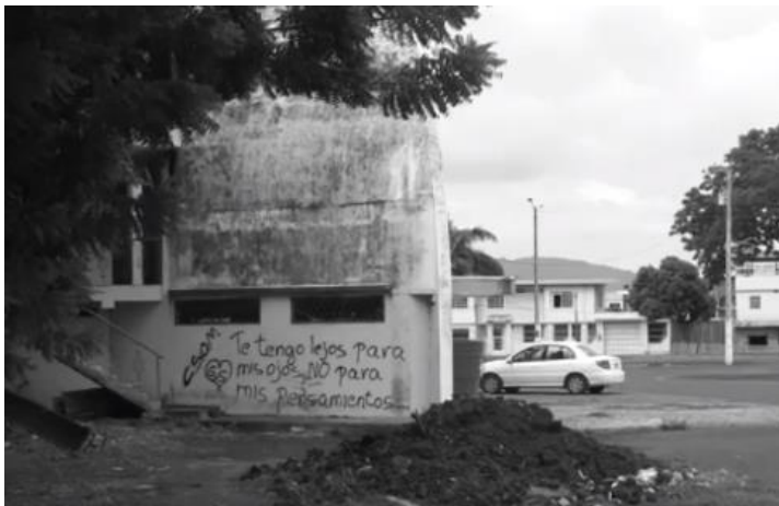
Gráfico No.21: Ex concha acústica en estado de deterioro (Parque La Rotonda antes).
