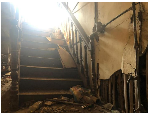
Gráfico No. 13. Roturas en la mampostería y escalera de la vivienda Viteri Guerrero de Portoviejo, provincia de Manabí. República del Ecuador. [20, junio, 2019]. Fuente: Fotografía tomada por autores de este análisis de caso.
