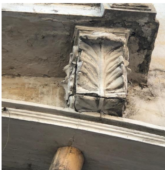
Gráfico No. 15. Deterioro en sus elementos decorativos de la vivienda Viteri Guerrero de Portoviejo, provincia de Manabí. República del Ecuador. [20, junio, 2019]. Fuente: Fotografía tomada por autores de este análisis de caso.
