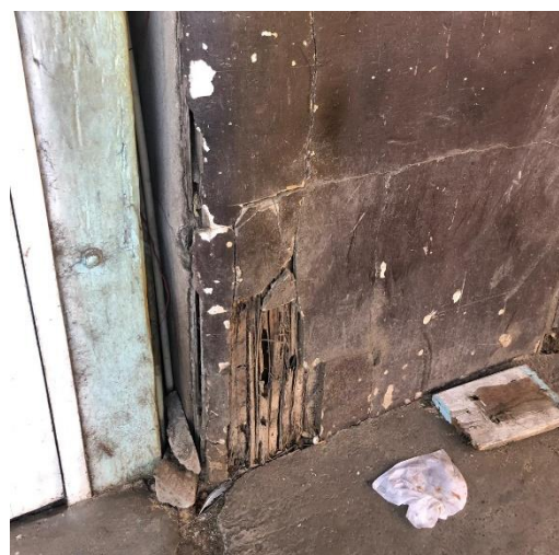
Gráfico No. 9. Daños de la mampostería planta baja de la vivienda Viteri Guerrero de Portoviejo, provincia de Manabí. República del Ecuador. [20, junio, 2019].
