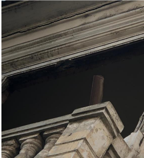
Gráfico No. 16. Daños en balcones de la vivienda Viteri Guerrero de Portoviejo, provincia de Manabí. República del Ecuador. [20, junio, 2019].
