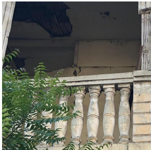
Gráfico No. 8. Deterioro del cielo raso de la vivienda Viteri Guerrero de Portoviejo, provincia de Manabí. República del Ecuador. [20, junio, 2019].
