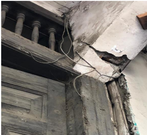
Gráfico No. 17. Fallos estructurales por deterioro de Portoviejo, provincia de Manabí. República del Ecuador. [20, junio, 2019].
