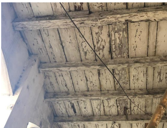
Gráfico No. 12. Deterioro de la estructura de madera de la vivienda Viteri Guerrero de Portoviejo, provincia de Manabí. República del Ecuador. [20, junio, 2019].
