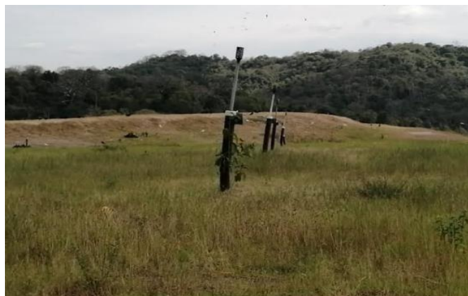
Gráfico No 27. Celda de Residuos sólidos, chimeneas para el tratamiento de los gases de los desechos posicionados sobre el área de remediación donde fue el cielo abierto del Relleno Sanitario. Portoviejo. República del Ecuador. Foto tomada por los autores del caso. [11, Julio, 2019]
