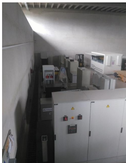
Gráfico No. 17. Sistema de procesamiento y transformación de energía ubicadas en planta baja del Centro de Energía Balzay de la Universidad de Cuenca. Cantón Cuenca. Provincia Azuay. (2019). Fuente: Fotografía realizada por los autores de este análisis de caso. [06, junio, 2019].
