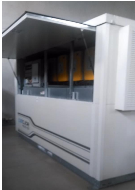
Gráfico No. 19. Batería de Flujo de Vanadio para almacenamiento de energía solar fotovoltaica ubicados en planta baja del Centro de Energía Balzay de la Universidad de Cuenca. Cantón Cuenca. Provincia Azuay. (2019). Fuente: Fotografía realizada por los autores de este análisis de caso. [06, junio, 2019].
