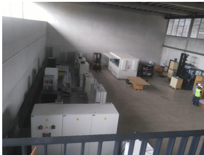
Gráfico No. 16. Planta baja del Centro de Energía Balzay de la Universidad de Cuenca. Cantón Cuenca. Provincia de Azuay. República del Ecuador (2019). Fuente: Fotografía realizada por los autores de este análisis de caso. [06, junio, 2019].
