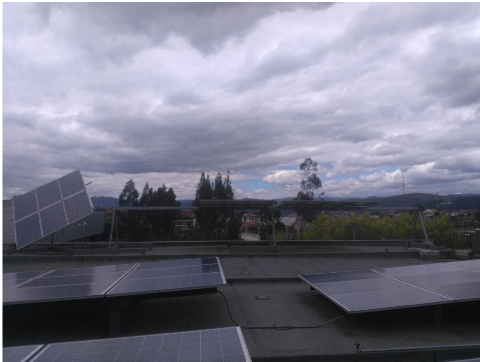
Gráfico No. 22. Paneles Fotovoltaicos tipo policristalino móvil en un eje con capacidad de seguimiento al sol Este-Oeste, y Paneles Solares con capacidad de movimiento en 2 ejes de tipo policristalino situados en la terraza del Centro de Energía Balzay de la Universidad de Cuenca. Cantón Cuenca. Provincia Azuay. (2019). Fuente: Fotografía realizada por los autores de este análisis de caso. [06, junio, 2019].
