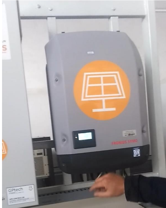
Gráfico No. 18. Inversor de energía de paneles solares fotovoltaicos ubicados en planta baja del Centro de Energía Balzay de la Universidad de Cuenca. Cantón Cuenca. Provincia Azuay. (2019). Fuente: Fotografía realizada por los autores de este análisis de caso. [06, junio, 2019].
