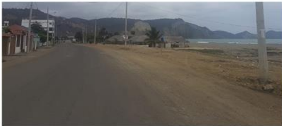
inexistencia de aceras
