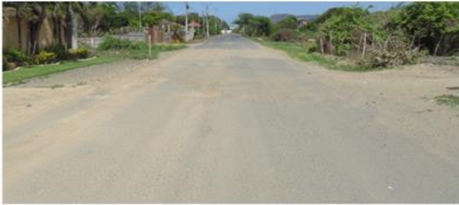
Mal estado de las via
