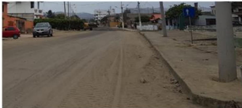
Mal estado de las via
