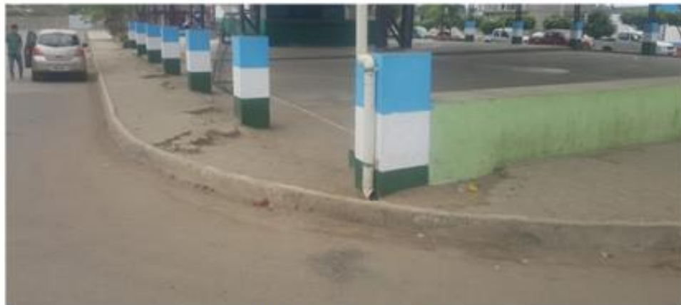
Mal estado de aceras
