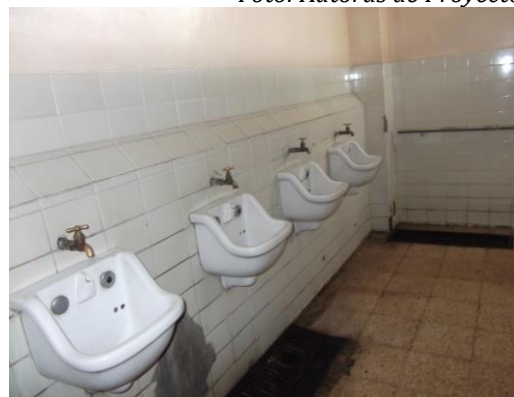
Ilustración 49. Baterías sanitarias - lavamanos L.P
