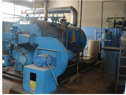
Ilustración 83. Cuarto de máquinas J.E.
