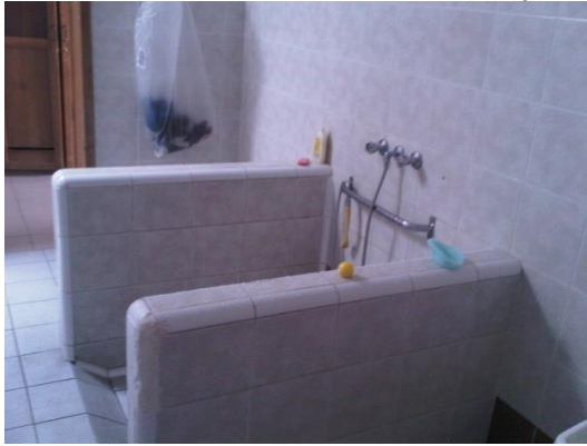
Ilustración 39. Baterías sanitarias – duchas S.C.
