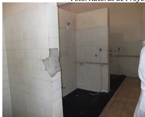
Ilustración 51. Baterías sanitarias - duchas L.P
