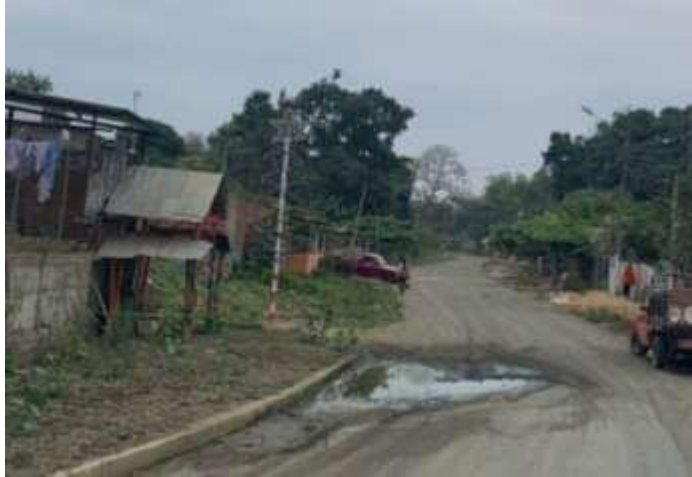
Ilustración 1. Falta de sumideros
